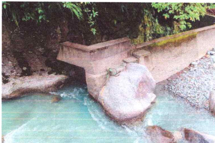
Ilustración 7 Estructura de captación lateral
