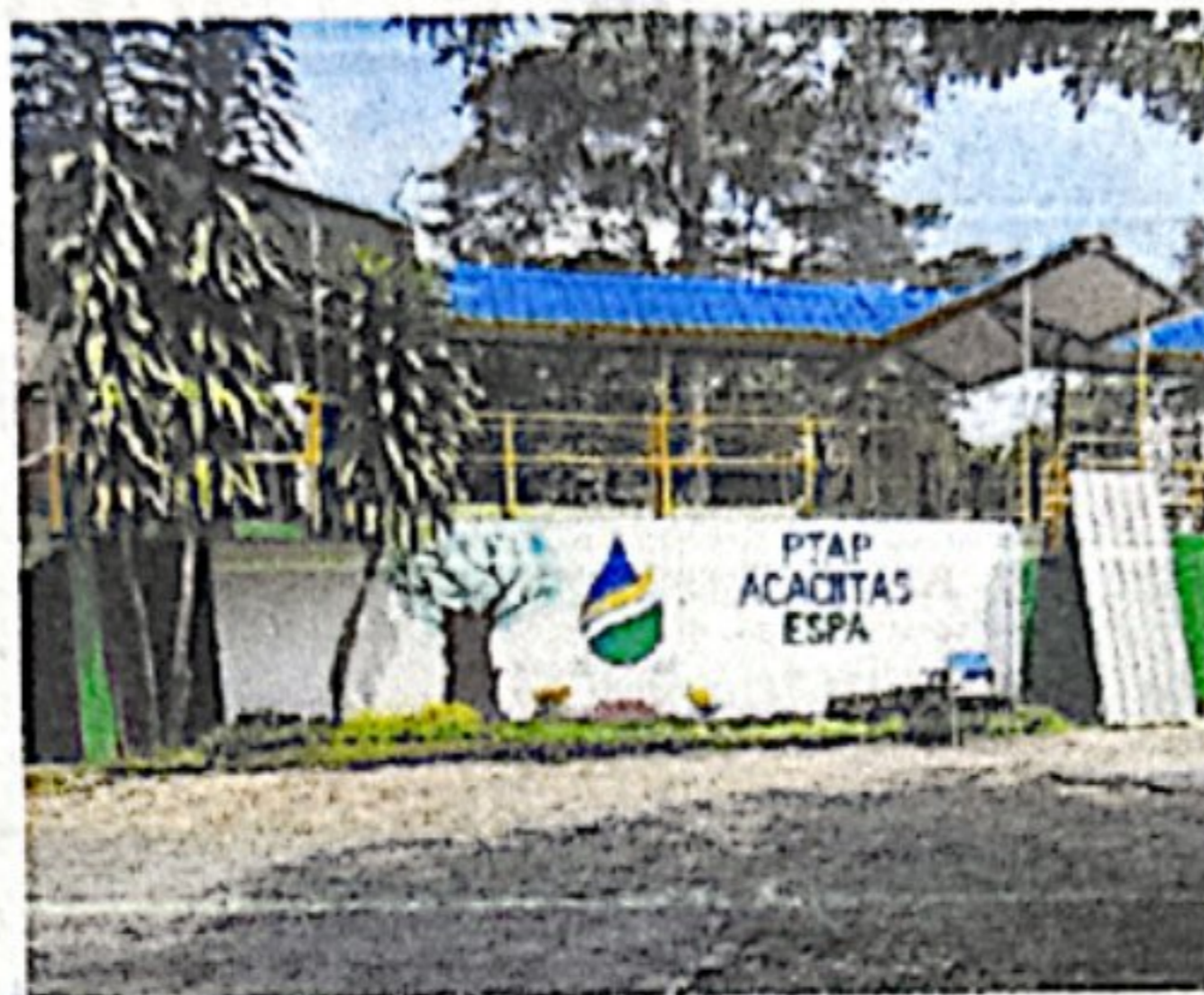
Fotografía 1. Planta de tratamiento de agua potable Acacitas
