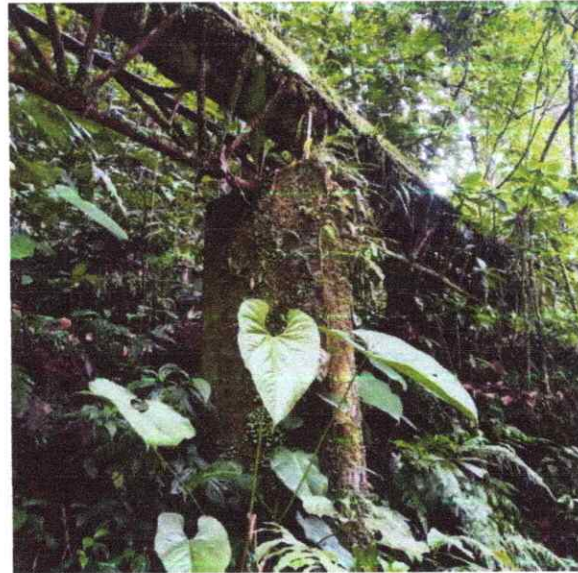
Estado general de elementos adyacentes al sistema principal y que sirven como viaducto para la conducción de la tubería. Presentan una avanzada cobertura vegetal.
